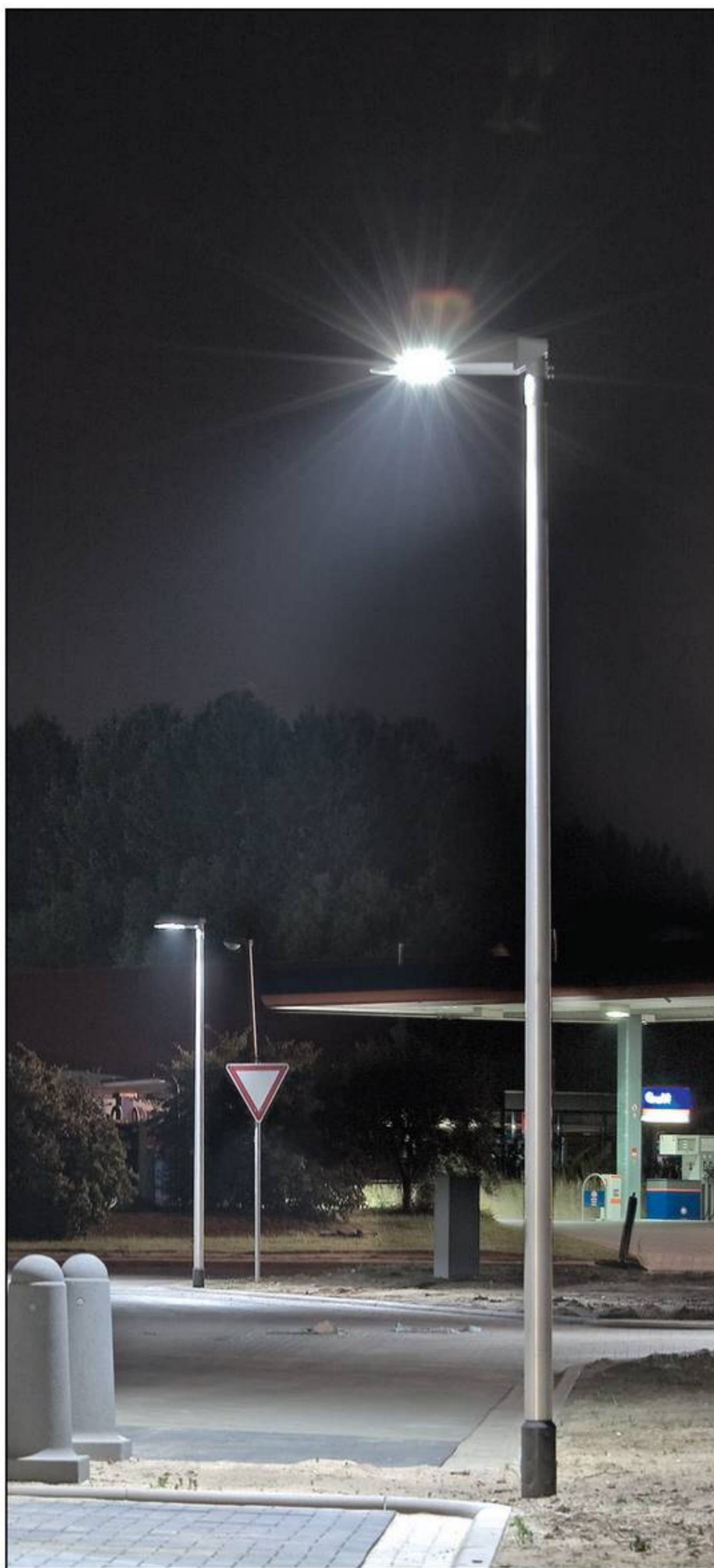
Umweltfreundlich, energiesparend, emissionsarm: Beleuchtungssysteme aus Pasewalk sind mit dem Einsparcontracting besonders für Kommunen interessant. Foto: Leuchten GmbH Pasewalk
